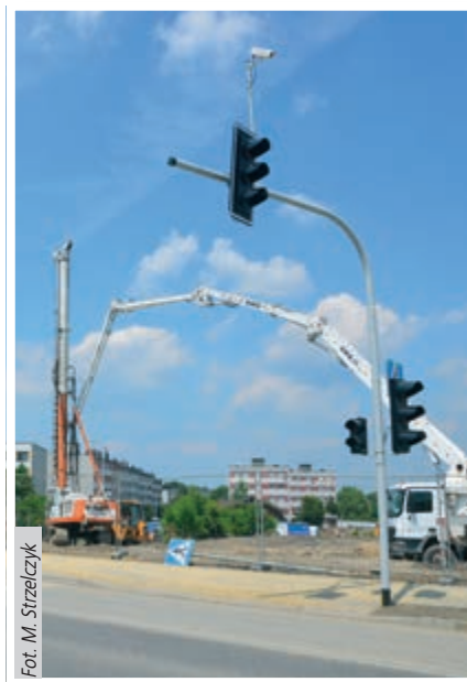
Sygnalizacja świetlna na skrzyżowaniu ulic św. Jana Pawła II i Ogrodowej
