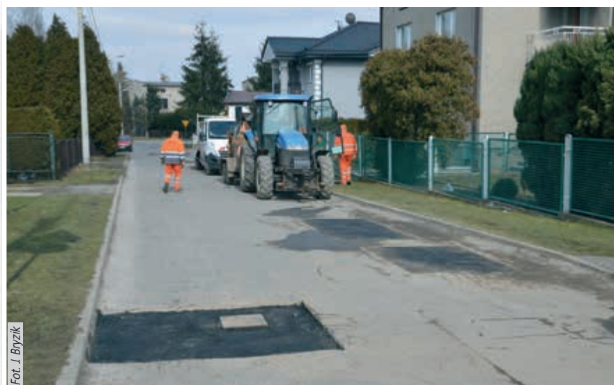
Na ul. Łącznej dziury zostały już załatane
