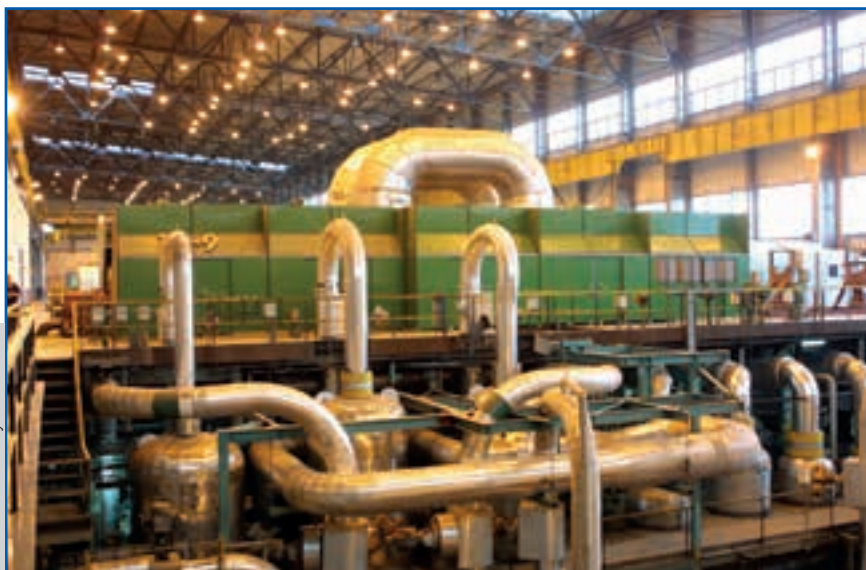
Widok maszynowni bloku 200MW
